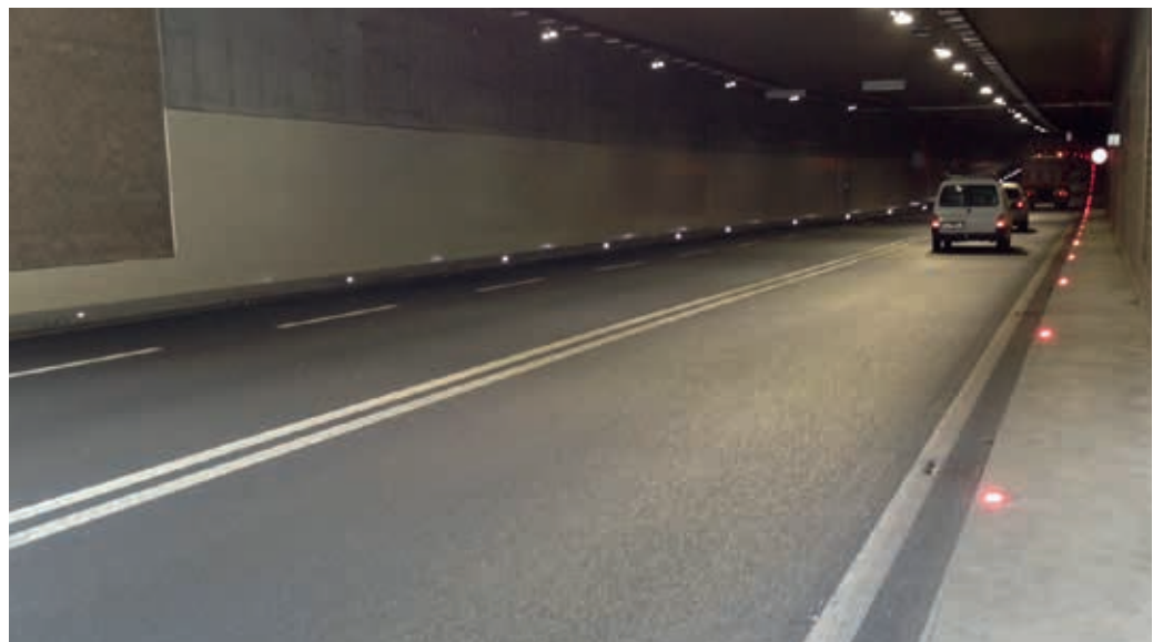
FlatLED 3 - Galleria autostradale
